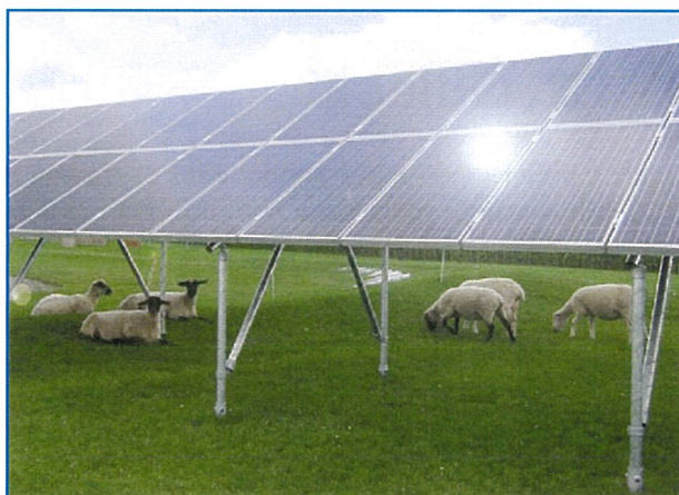
Pacage de moutons sous les panneaux
