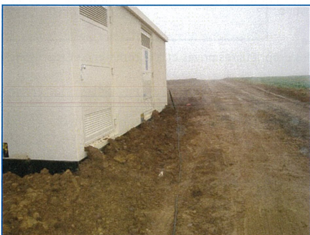
Postes électriques (piste provisoire)
